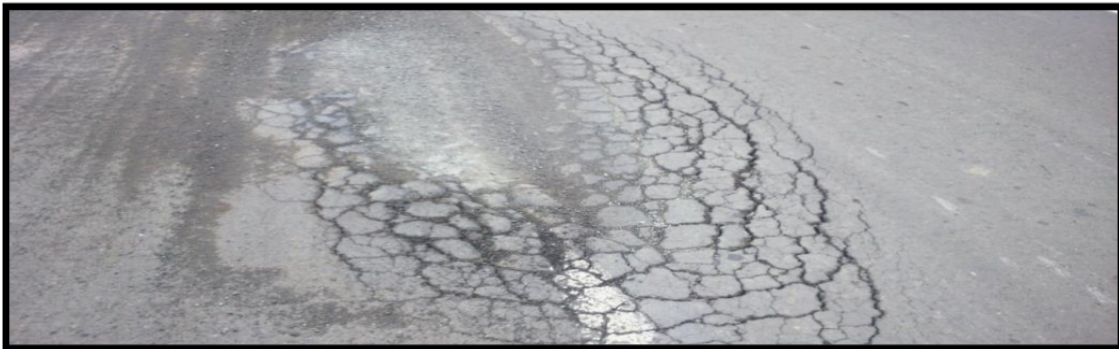
Figura 10 Daños en pavimento de vía principal de urbanización Mucho Lote 2
