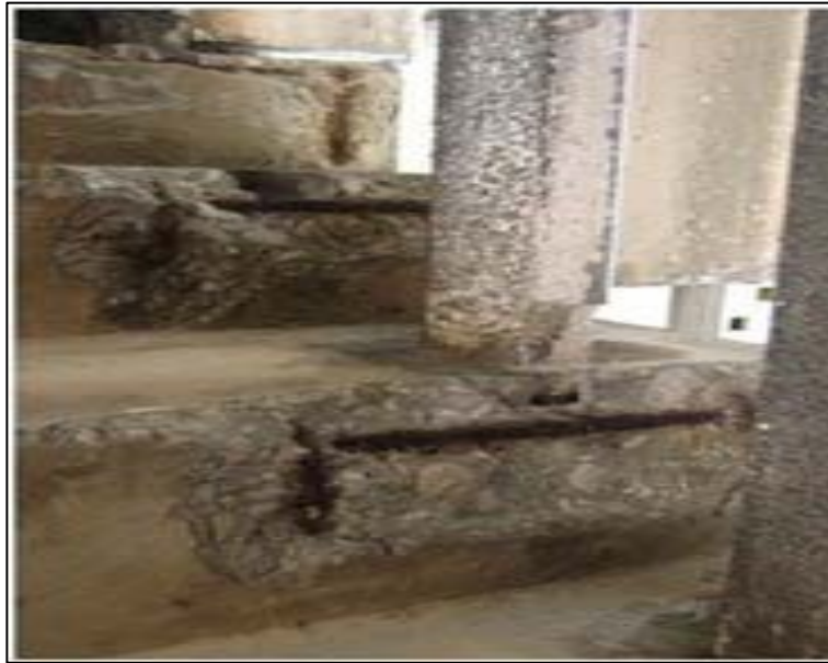
Figura 29. Efectos en el hormigón
