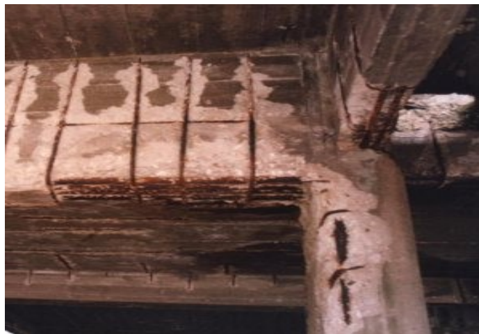
Figura 30. Efectos en el sistema Hormigón Armado
