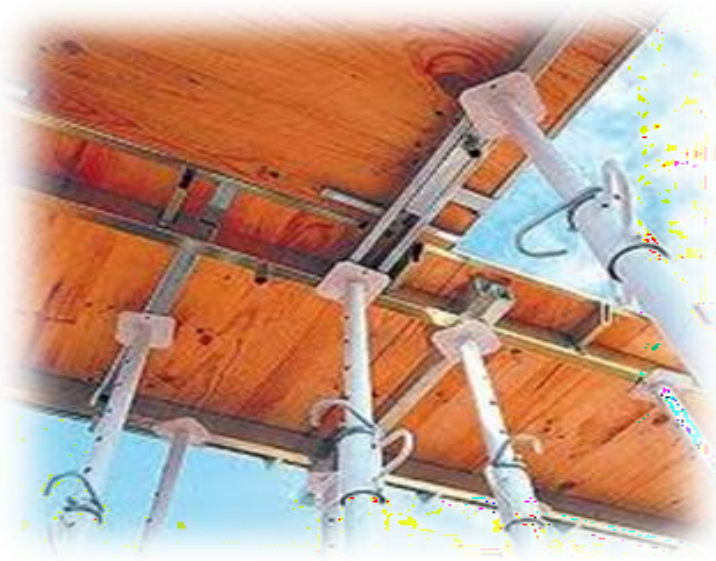
Figura 24: Losa apoyada en madera
