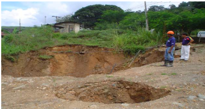
Figura I.11. Fotos donde se muestran hundimientos provocados por la minería subterránea en Portovelo.
