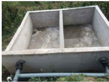
Foto 36: Vista del lecho de lodos
