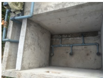
Foto 33: Vista del interior de Trampa de Grasas
