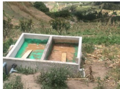
Foto 42: Otra vista del Lecho de Lodos
