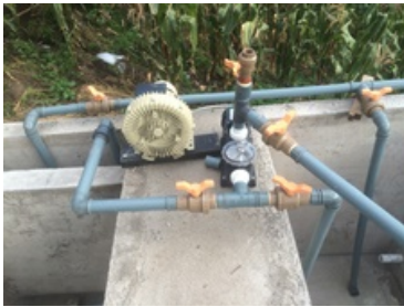
Foto 31: Disposición de Blower y Bomba
