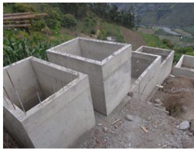
Foto 27: Vista parcial de la PTAR's PFSA
