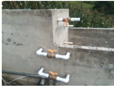
Foto 35: Vista de Bypass 2do-3er tanque
