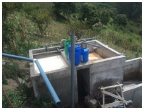
Foto 38: Otra vista de Operación de PTAR's
