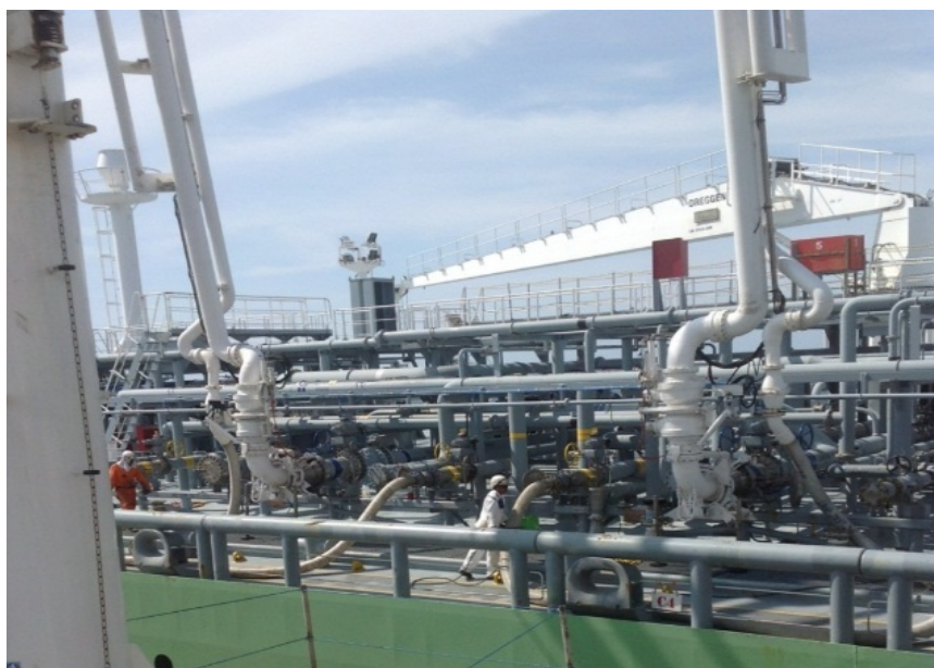
Ilustración 77.- comisionado de líneas de GLP
