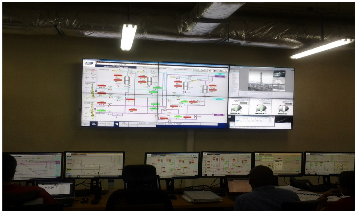
Ilustración 309.- control de llenado de tanques y esferas en cuarto de control
