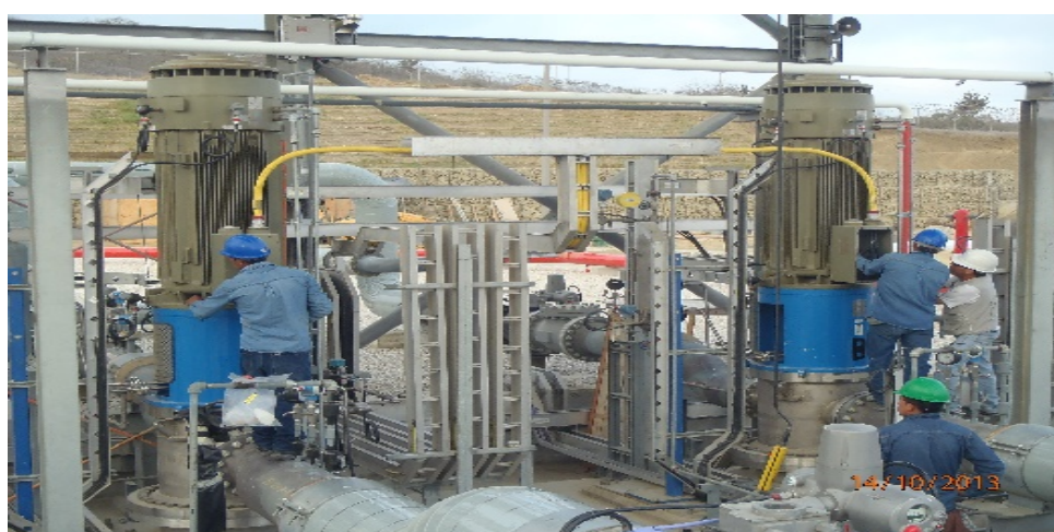
Ilustración 43.- bombas de transferencia de GLP
