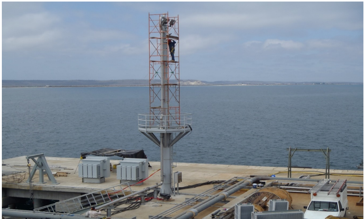
Ilustración 150.- instalación de monitores del sistema contra incendio de la plataforma de operaciones
