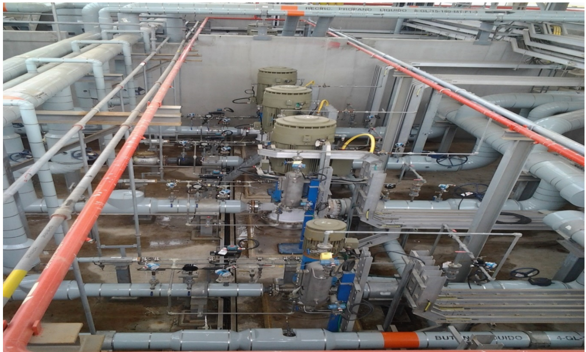
Ilustración 294.- cuarto de bombas de procesos
