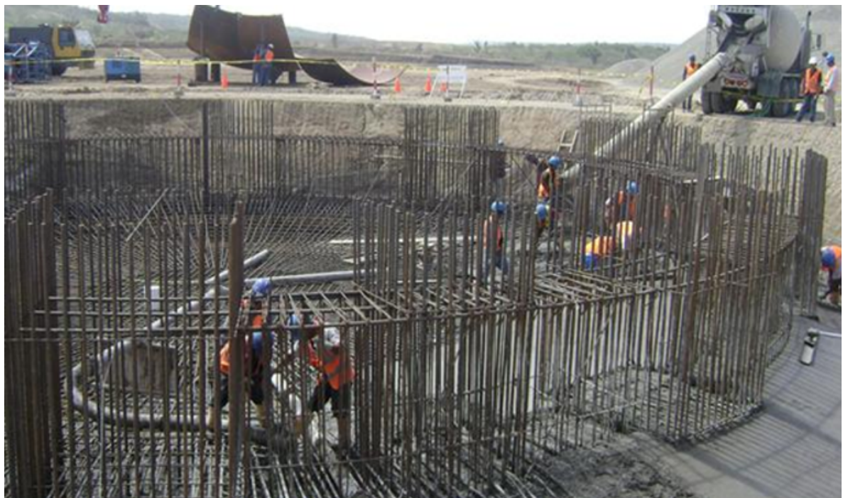
Ilustración 220.- armado de acero de refuerzo y encofrado de las bases de las esferas
