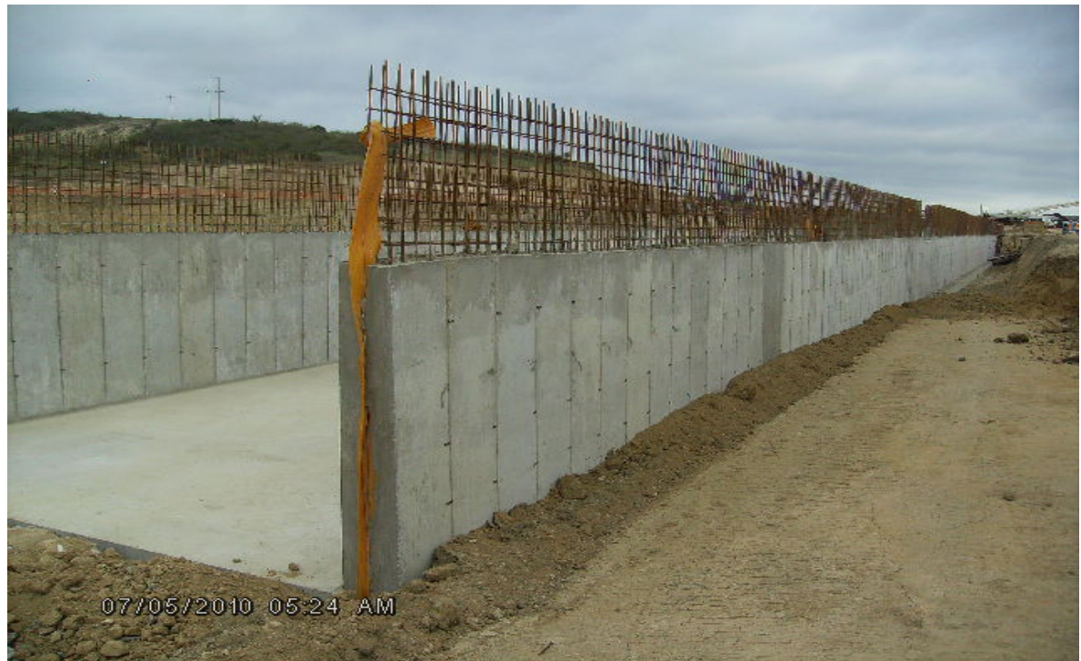
Ilustración 216.- avance de trabajos de obras civiles en pipe – way piso y paredes
