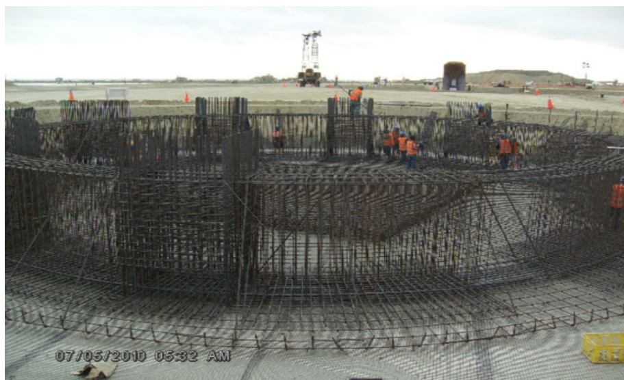
Ilustración 28.- base de esfera ef-1301 a, armado de hierro para anillo y bases de hormigón
