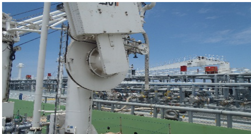
Ilustración 82.- control de descarga de propano y butano desde buque gasero
