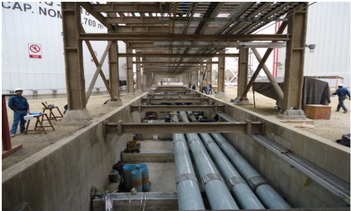
Ilustración 278.- aislamiento térmico de tuberías en pipe way
