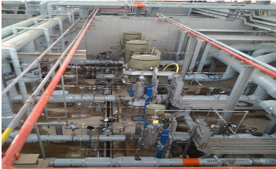
Ilustración 44.- bombas de propano y butano
