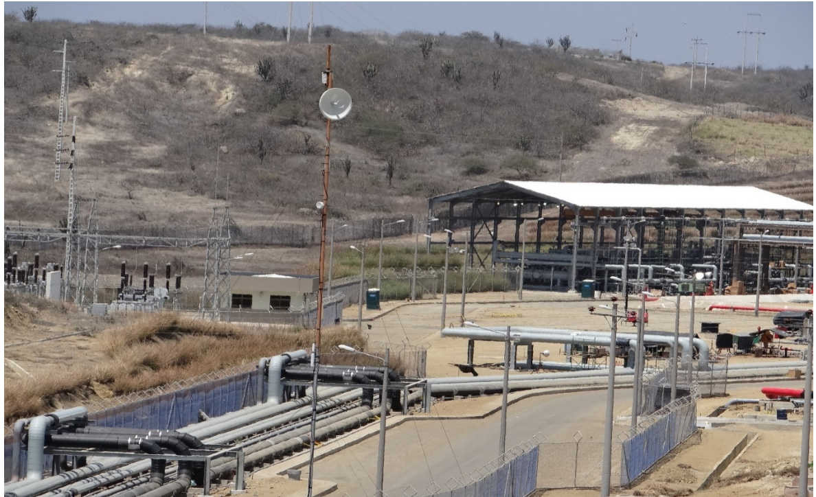
Ilustración 298.- pipe way y equipo de frío
