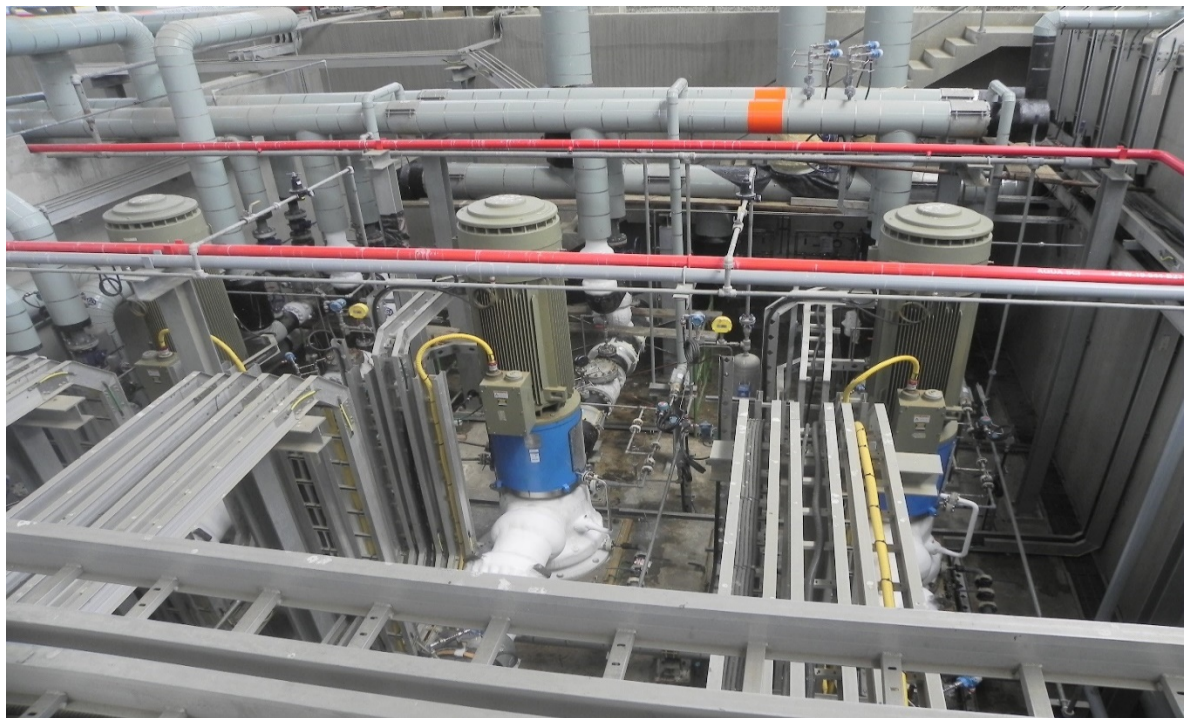
Ilustración 306.- comisionado de bombas de procesos
