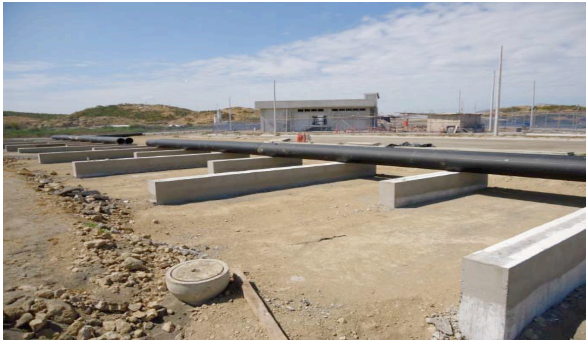
Ilustración 271.- inicio de colocación de la tubería del sistema contra incendio sobre los durmientes de la tubovía
