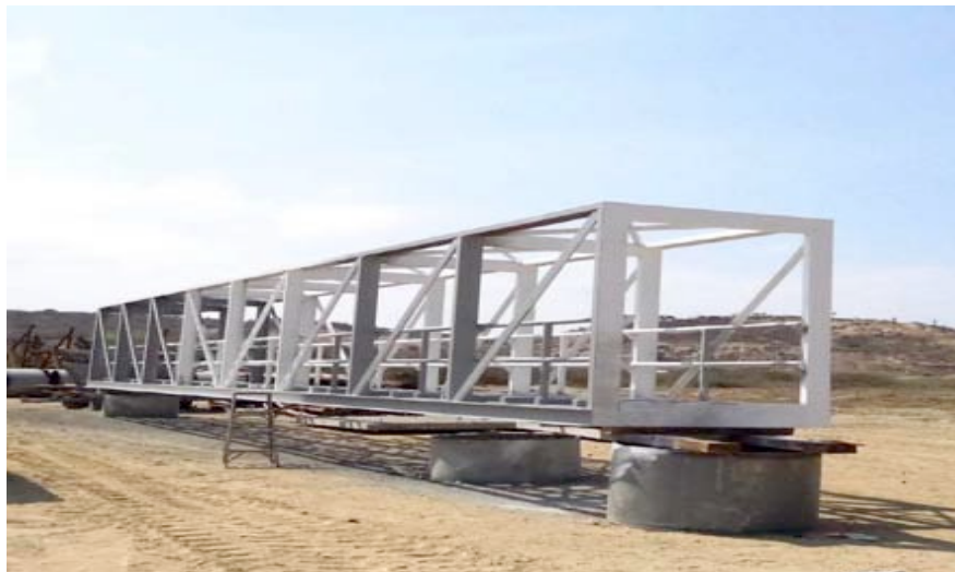
Ilustración 134.- pintura de pasarelas de acceso a dat y dam desde plataforma de operaciones y muelle de acceso
