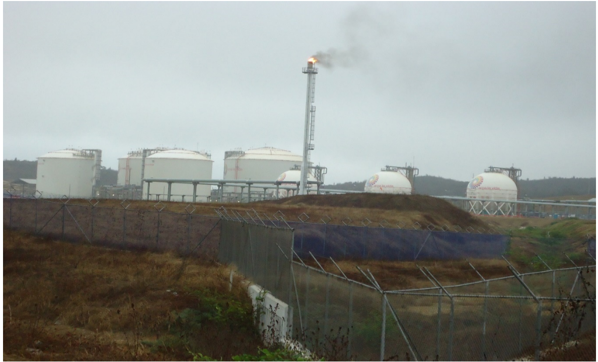
Ilustración 307.- comisionado de flare – recepción de glp
