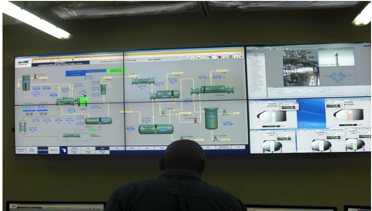
Ilustración 310.- control de llenado de tanques y esferas en cuarto de control
