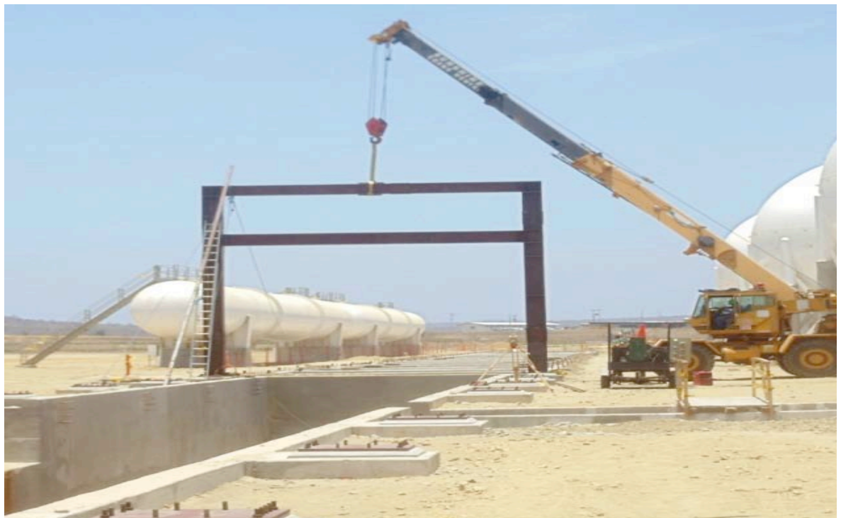
Ilustración 260.- montaje de pórtico en pipe rack entre tanques de propano y butano
