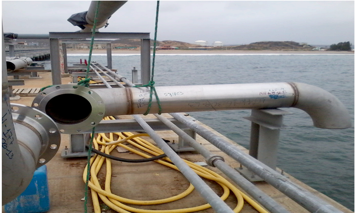
Ilustración 149.- soldadura de tubería dúplex en plataforma de bombas del sistema contra incendio
