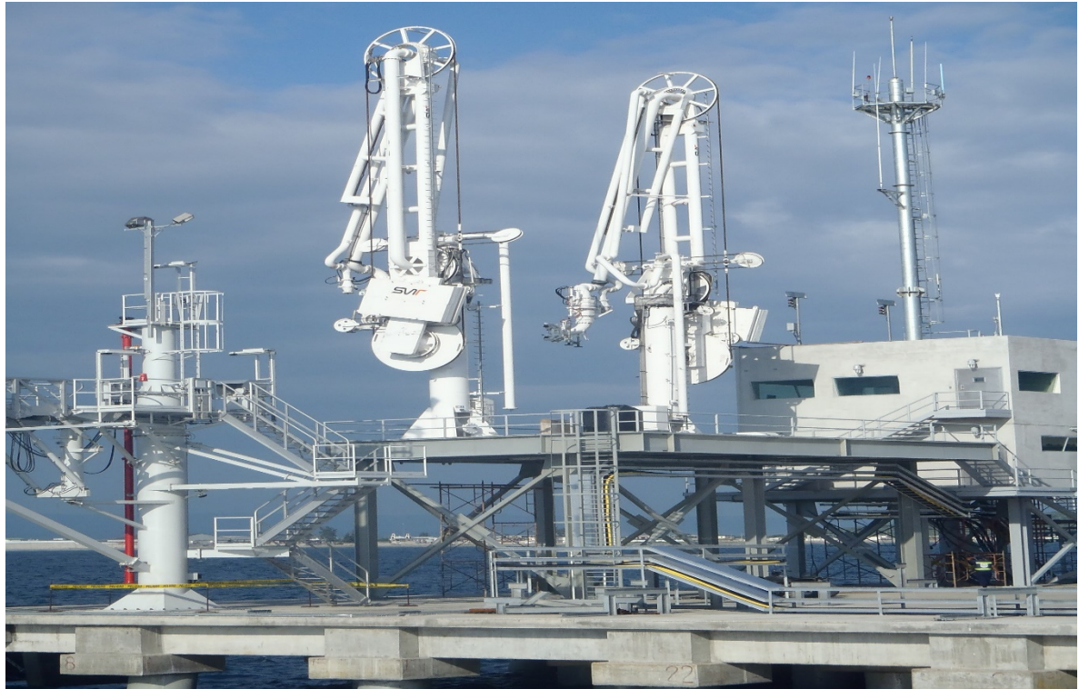
Ilustración 151.- instalación de brazos de carga y descarga
