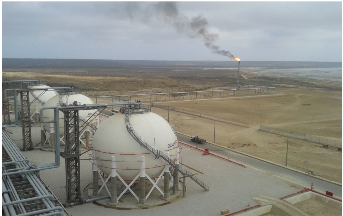
Ilustración 308.- comisionado de flare – recepción de glp
