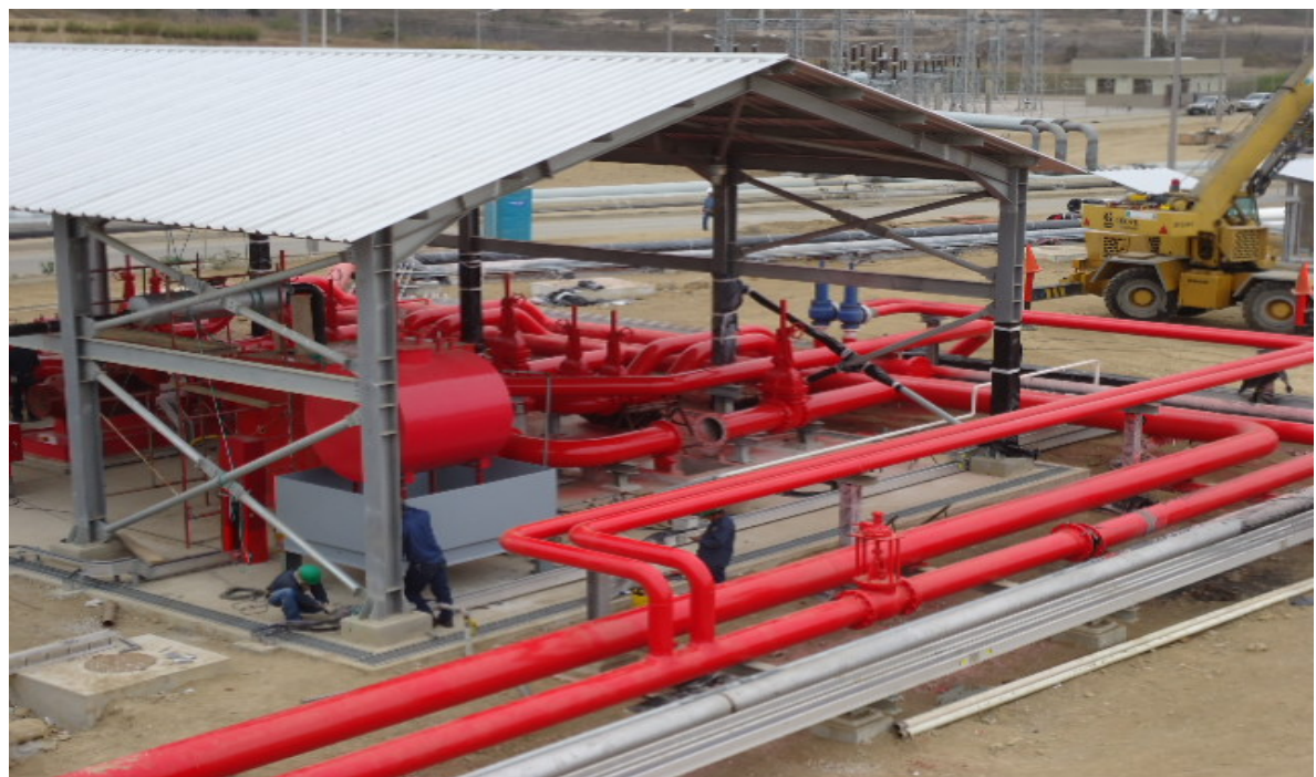
Ilustración 274.- montaje de junction box y bandejas porta cables en edificio de bombas del sistema contra incendio
