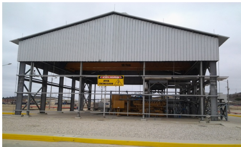
Ilustración 45.- casa de generadores auxiliares caterpillar
